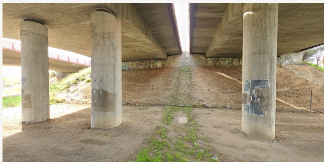
Estribos de puente afectados por reacciones expansivas de tipo árido-álcali
